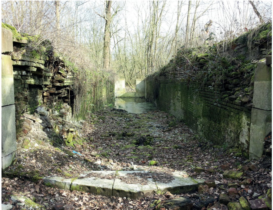
Figuur 13 Overzicht schutsluis. Foto Frances Kannekens (2016)
